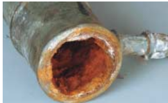
Corrosion et entartrage sont les maux qui guettent le bon fonctionnement des réseaux sanitaires.
