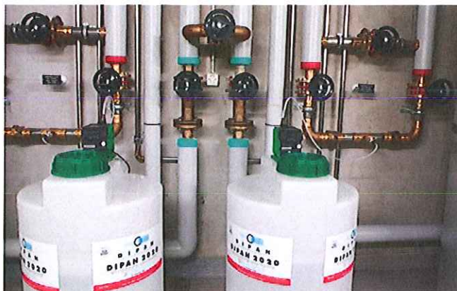
Dosieranlage für die Beimischung von Silikat, wie es natürlicherweise - in geringeren Mengen - im Trinkwasser vorkommt.
